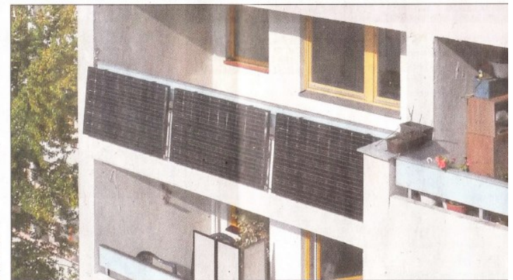
Sogar mit kleinsten Solaranlagen lässt sich die Energiewende unterstützen: Sie können am Balk Platz finden. • Foto: indielux/dpa-tmn
